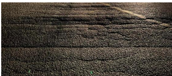
Figura 2: Irregularidade Longitudinal através da anomalia corrugação. Fonte: Primeira autora.
